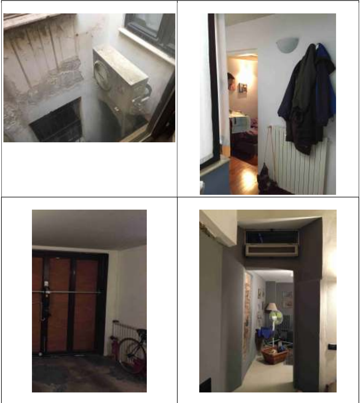
Figura 08: Impianti in dotazione all'immobile
